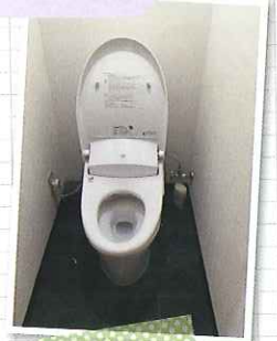
トイレ【ウォシュレット完備】 卫生间(设有温水洗净座便器) 洗手间(设有免治马桶座)
